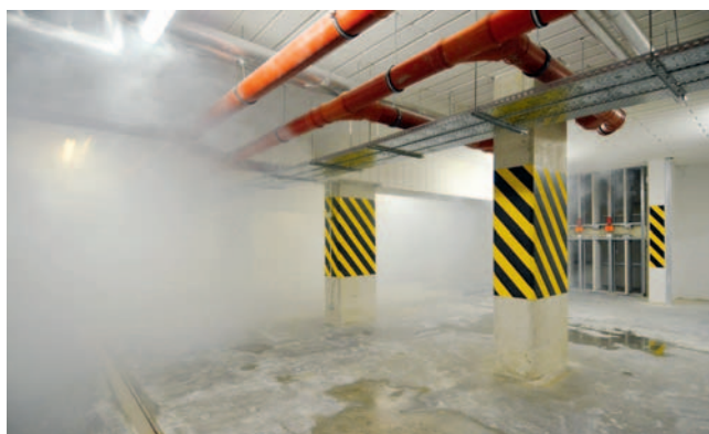
Fot. 8. Próba w przestrzeni garażu podziemnego oddymianego strumieniowo
