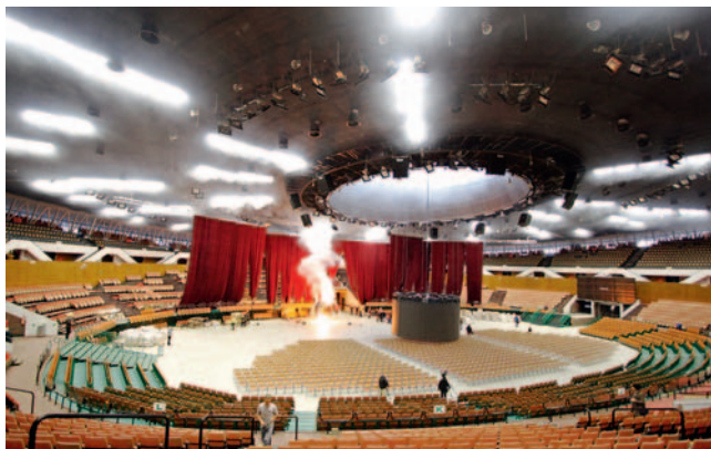
Fot. 9. Próba w hali widowiskowo-sportowej (oddymianie grawitacyjne)
