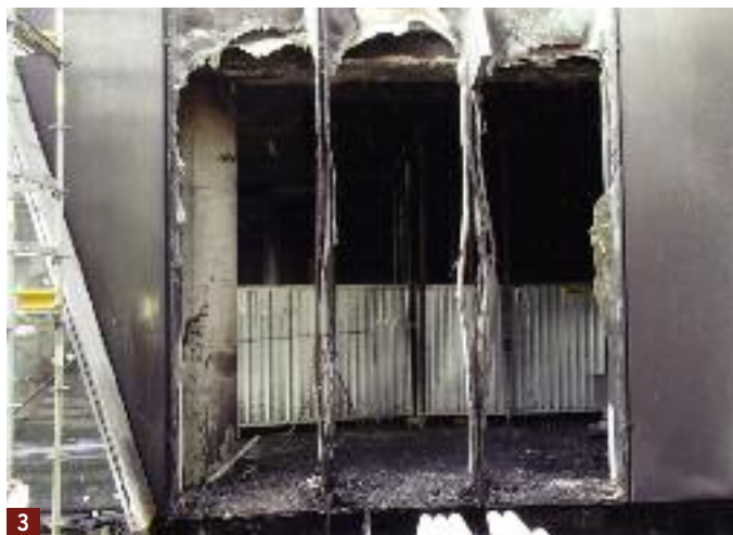
Skutki pożaru w trakcie budowy wysokościowego budynku biurowego przy ul. Jana Pawła II w Warszawie (fot. A. Laudy, arch. KM PSP w Warszawie)
