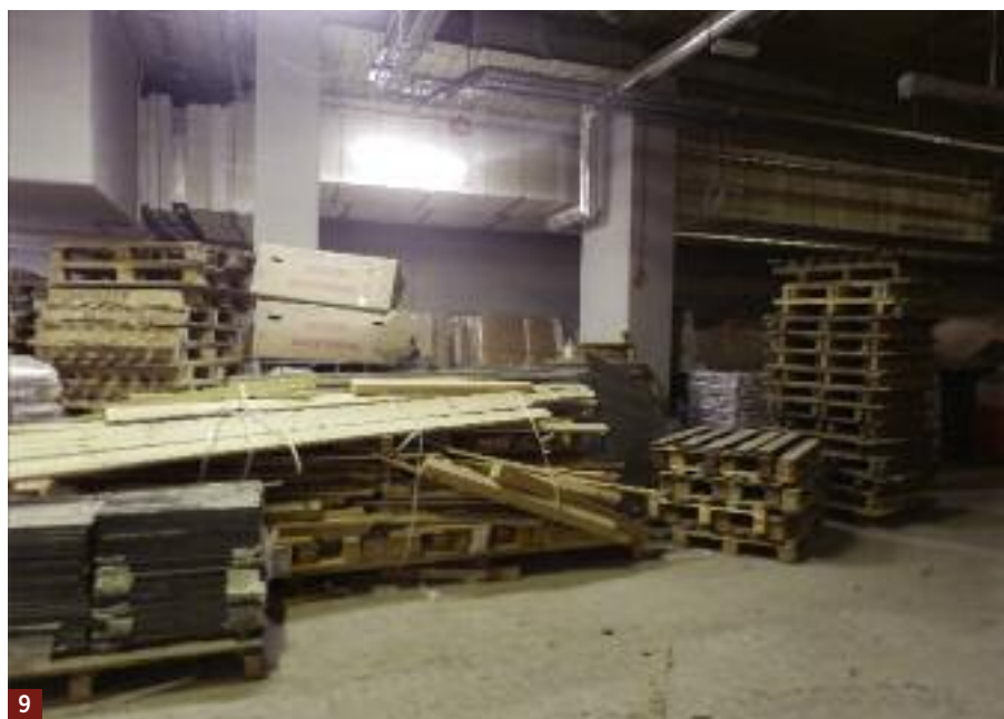
Palne odpady budowlane składowane na kondygnacji podziemnej wznoszonego budynku biurowego wysokościowego
