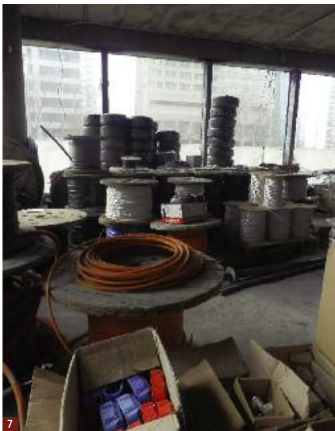
Duże ilości palnych kabli składowane wewnątrz wznoszonego budynku
