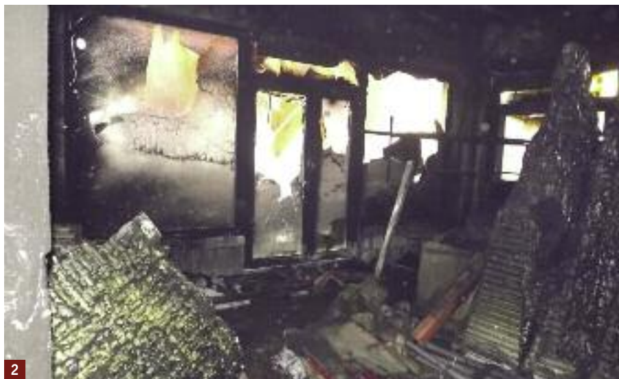
Skutki pożaru w trakcie budowy budynku mieszkalnego przy ul. Remiszewskiej w Warszawie (fot. B. Bogdanowicz, arch. KM PSP w Warszawie)
