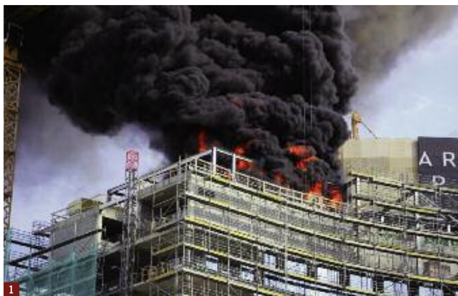
Pożar w trakcie budowy budynku biurowego w Warszawie (źródło: www.tvnwarszawa.tvn24.pl )
