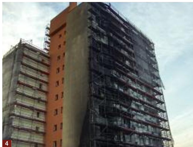
Skutki pożaru w trakcie termomodernizacji budynku mieszkalnego w Bytomiu (źródło: KM PSP w Bytomiu)
